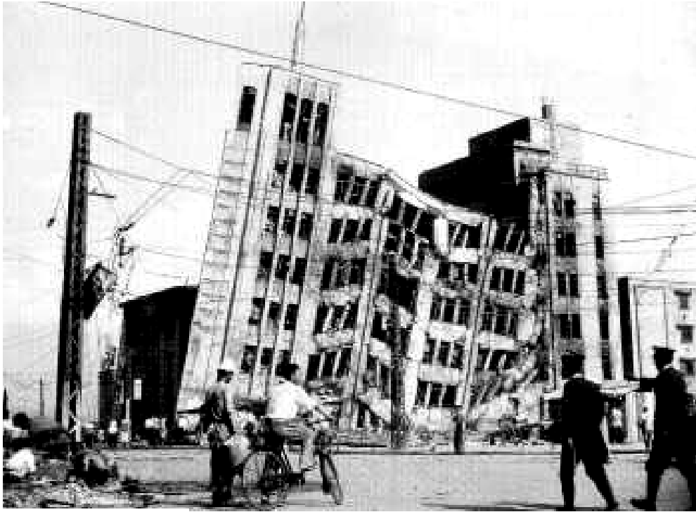
福井地震により倒壊寸前の被害を受けた大和デパート
