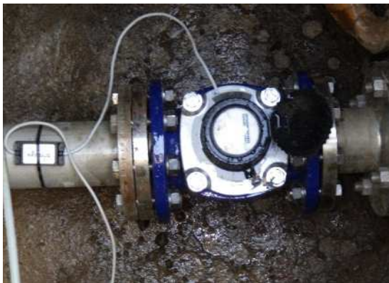
美山地区 下宇坂地区 配水流量計
