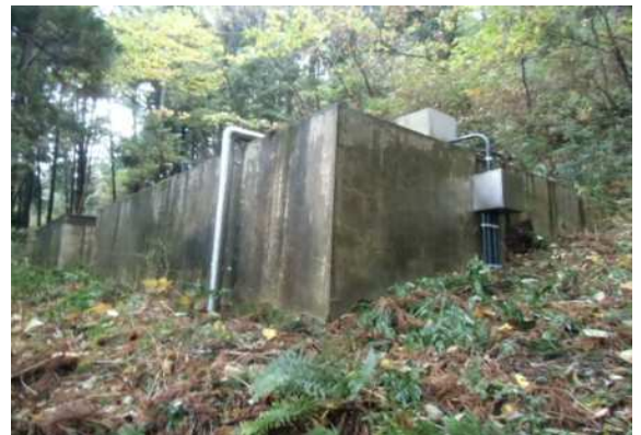
越廼地区 北部 第2配水池
