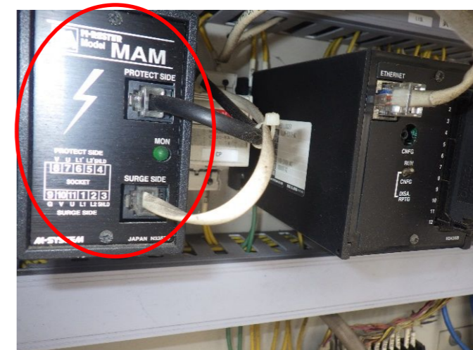
< マンホール盤内にあるSPD(避雷器) >
