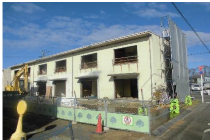
用途廃止を要する老朽化住宅の例
