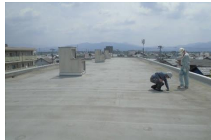
劣化した屋上防水の例
