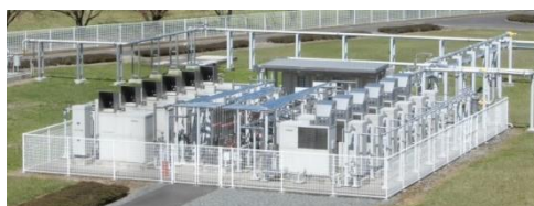
消化ガス発電装置
