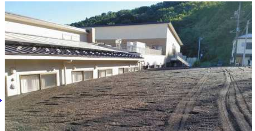
被災状況:施設1階に土砂が流入(高さ1.6m)
