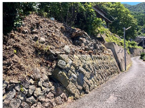
図 3-8 崩壊の危険があった石積み (浜北山町)
