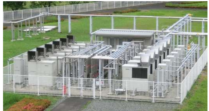
消化ガス発電設備 設置状況
