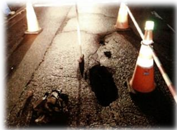
<下水管の老朽化に起因する道路陥没>
