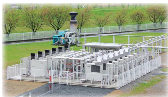
<消化ガス発電設備>
