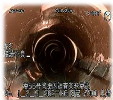
<老朽化した下水管の内部>
