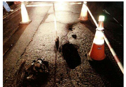
管の老朽化に起因する道路陥没
