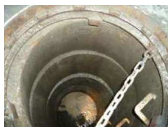
マンホールのズレ
