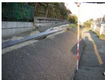
管路部の浮上
