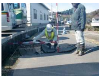
マンホールの浮上
