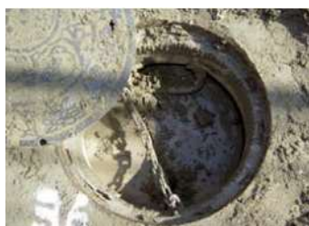
マンホールへ土砂堆積
