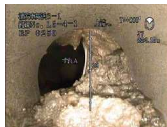
管きよのずれ、土砂侵入
