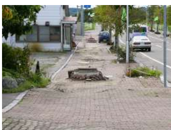
マンホールの浮上
