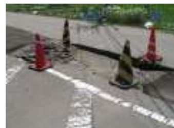
管路部の道路陥没
