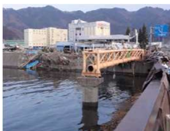
水管橋の被害
