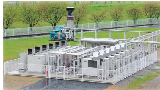
<消化ガス発電設備>
