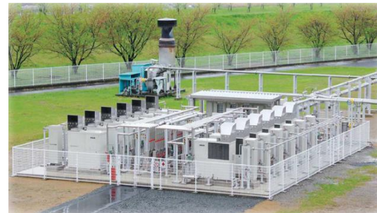
<消化ガス発電設備>
