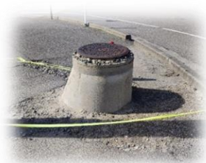
(マンホールの浮上)
