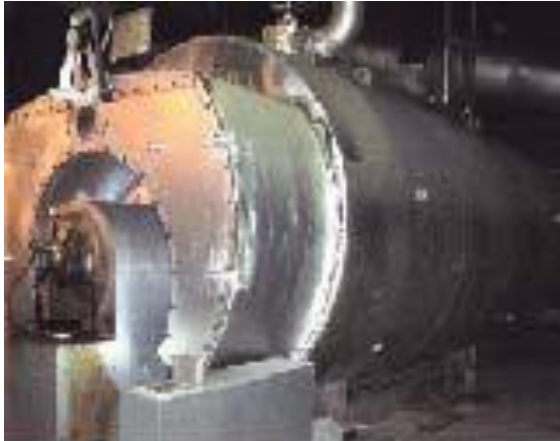
ボイラーに使用された例
