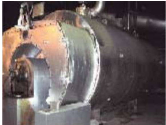
ボイラーに使用された例
