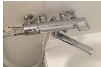
写真Ⅱ.26 サーモスタッド付の給湯用カラン
