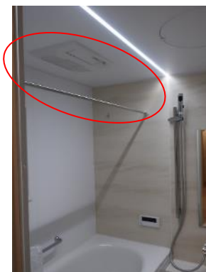
写真Ⅱ.31 浴室の換気暖房乾燥機と 吊り下げ式物干し
