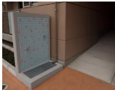
写真Ⅱ.77 住棟入口に設けられた手洗い場
