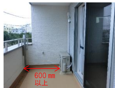
写真Ⅱ.52 手すりからの離隔距離を確保した 室外機置場
