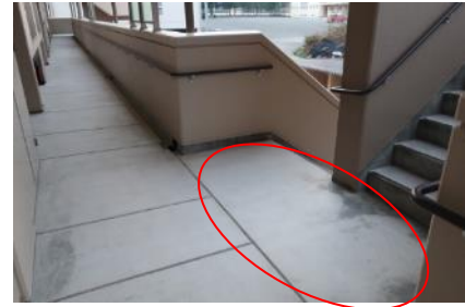
写真Ⅱ.65 共用階段と共用廊下の歩行者どうしの衝突防止に配慮された階段（階段最上段の共用廊下への食い込み、最下段の共用廊下への突出の防止）
