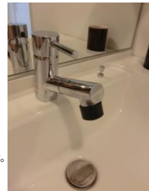
写真Ⅱ.30 洗面台のレバーハンドル式水栓。 伸縮式シャワー水栓でもある
