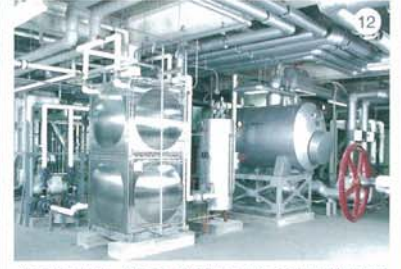
余熱利用設備…冷暖房、給湯用温水や、高温水を作ります
