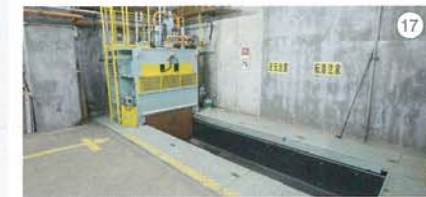
粗大可燃物破碎機…可燃粗ごみを切断します
