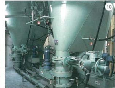
消石灰活性炭供給装置…有害なガスなどを除去します
