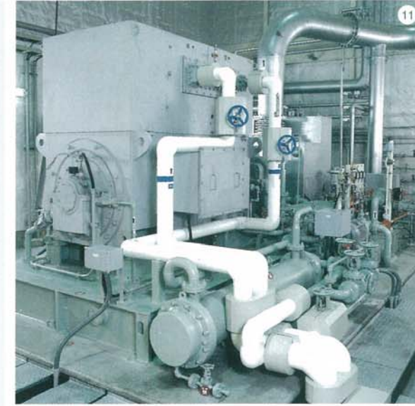
タービン発電機…発生蒸気を使って発電します
