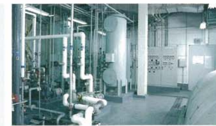
排水処理装置…排水を再利用するため処理します
