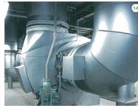
誘引送風機…排出ガスを煙突に導きます
