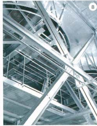
タービン排気復水器…蒸気を復水します
