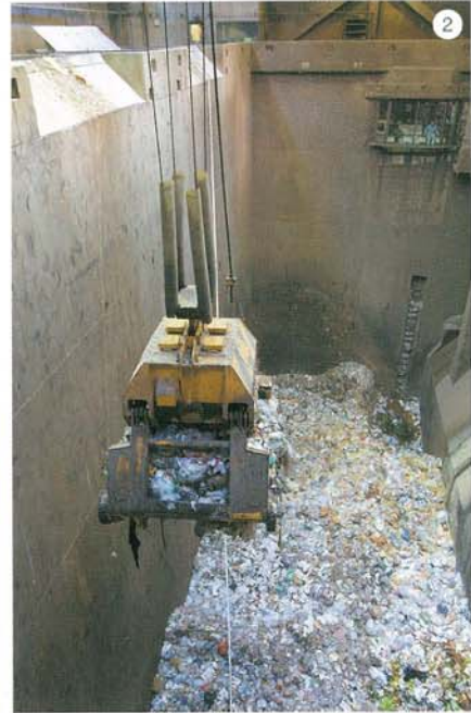
ごみピットとクレーン…収集ごみを貯留します
