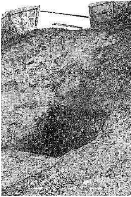
図6-6 廃石綿等の埋立用穴
