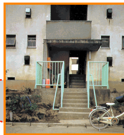
地盤沈下により建物が抜け上がってしまった後の建物
