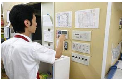
電力のデマンド監視装置
