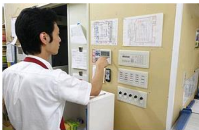
電力のデマンド監視装置
