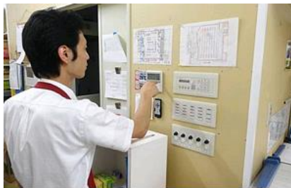
電力のデマンド監視装置
