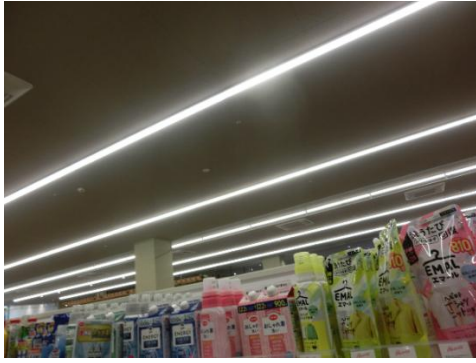
LED 照明を導入している
