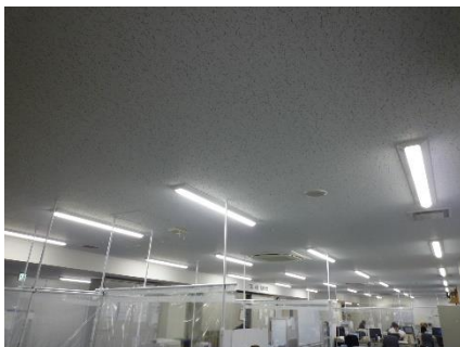
LED 照明を導入
