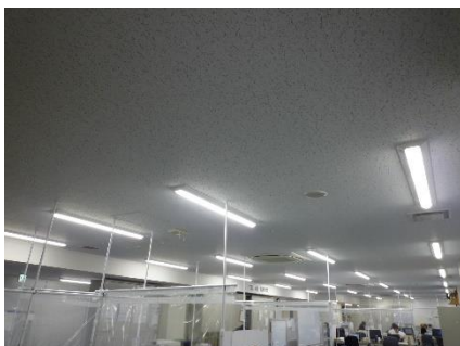
LED 照明を導入
