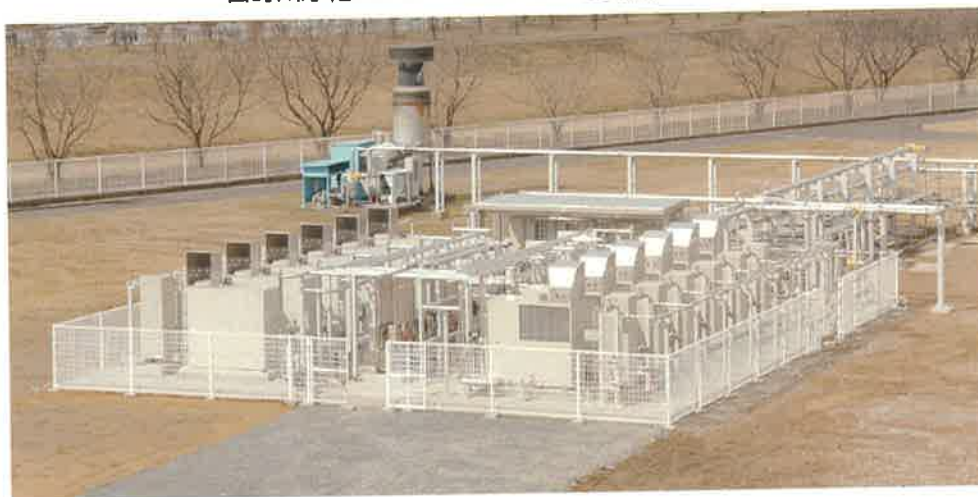
下水の処理過程で発生する「消化ガス」を利用した発電設備（出力300 kW）
