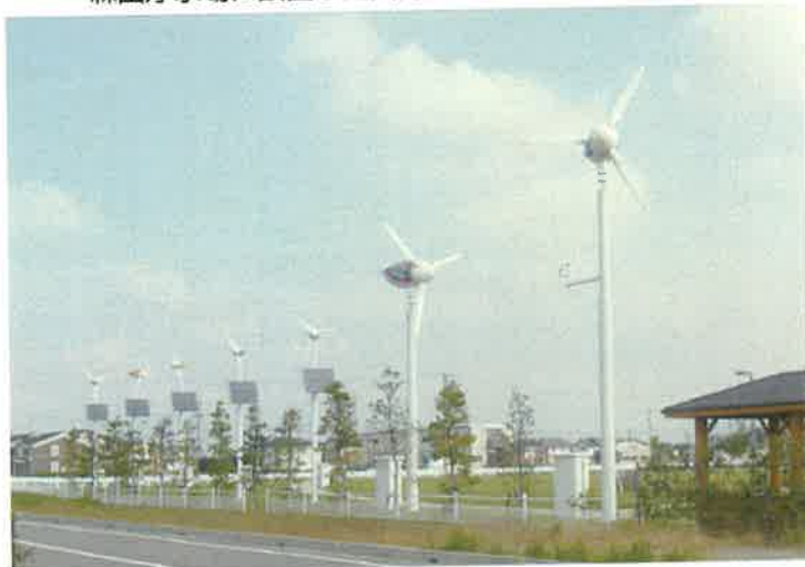
風力発電装置（手前2基・出力4kW）と風力発電と太陽光発電を利用したハイブリッド型照明灯（奥5基・風力出力1kW 太陽電池出力168W）
