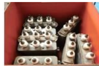
鋼製容器への収納例
