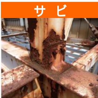
鉄骨やボルトのサビは、 破損の前兆
