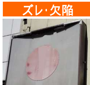
盤面のズレや取付具の 欠落は、落下の前触れ
