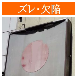
板面のズレや取付具の 欠落は、落下の前触れ
