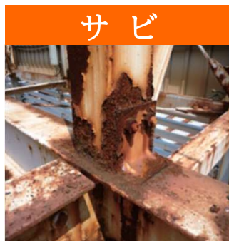
鉄骨やボルトのサビは、 破損の前兆
