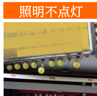
漏電の場合は、火災の 危険も
