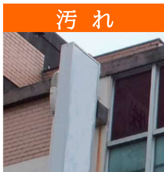
サビ汁がたれていたら、 内部が腐食しているかも
