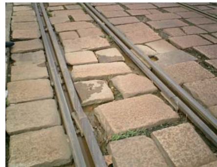
老朽化の激しい敷石軌道
