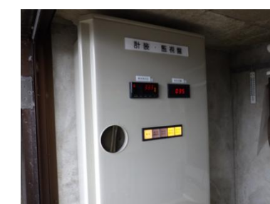
《遠方監視システム》
