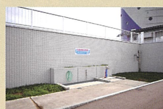
災害時給水施設①
