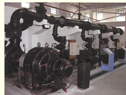
▲足羽山の上にある配水池に水を あげる大型ポンプ
