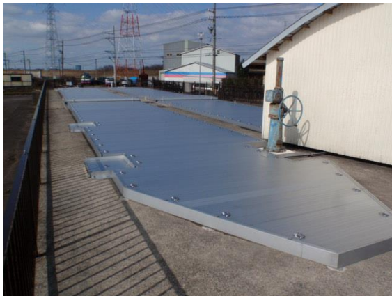
中ノ郷取水場沈砂池
