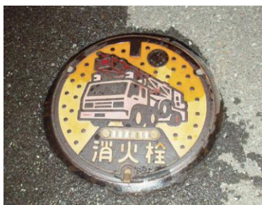
地下式消火栓
