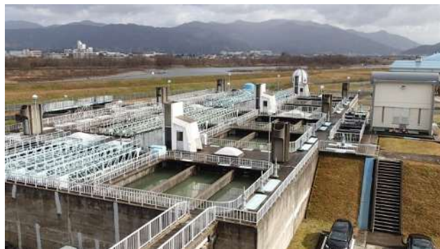
九頭竜浄水場の薬品沈澱池
