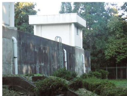
現在の原目配水池
