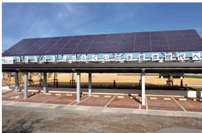
太陽光発電設備（森田浄水場）
