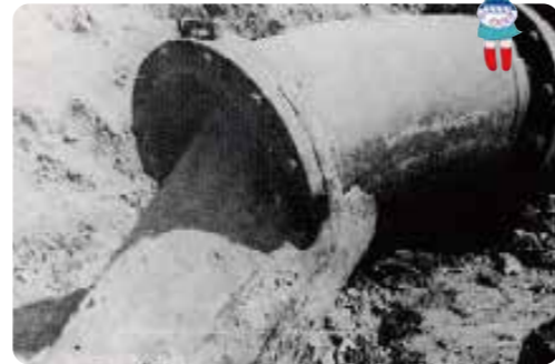
配水管の損壊(幸橋北詰)
