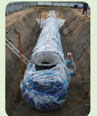
非常用貯水装置設置状況
