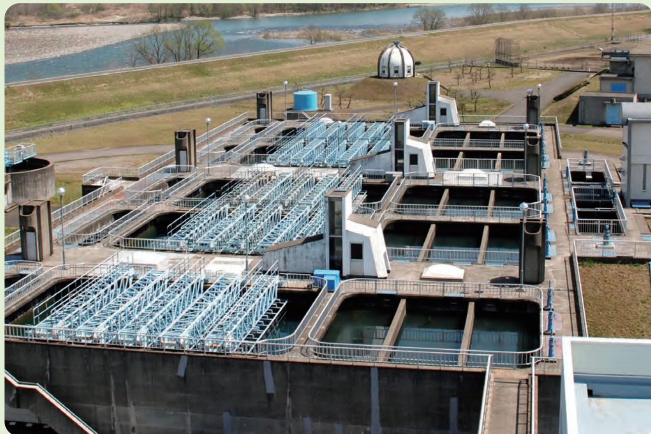
九頭竜浄水場薬品沈澱池
