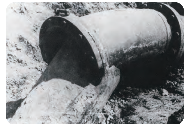
配水管の損壊
