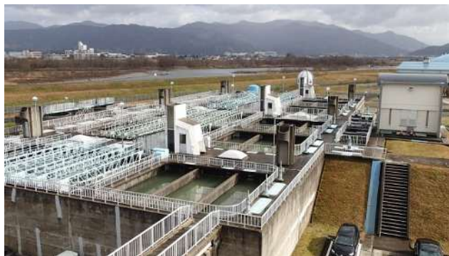
九頭竜浄水場の薬品沈澱池
