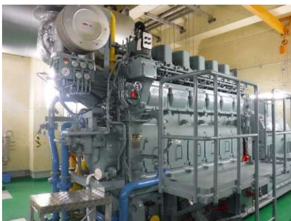
非常用発電設備（九頭竜配水ポンプ場）
