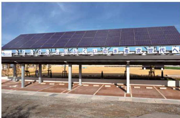
太陽光発電設備（森田浄水場）
