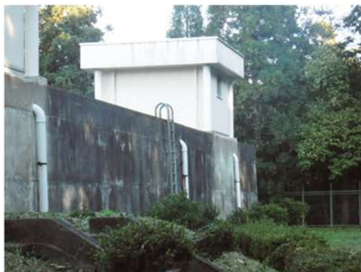
現在の原目配水池
