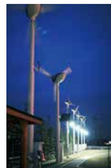
風力発電機（森田浄水場）
