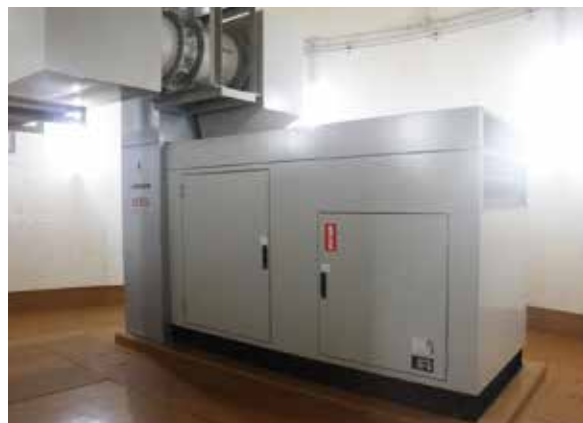
非常用発電設備（森田浄水場）
