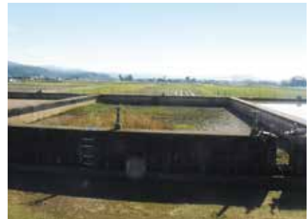
天日乾燥床（九頭竜浄水場）
