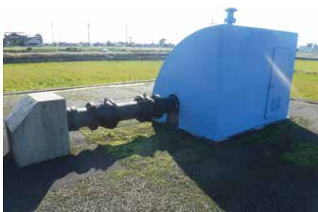
九頭電深第3水源井
