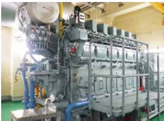
非常用発電設備（九頭竜配水ポンプ場）
