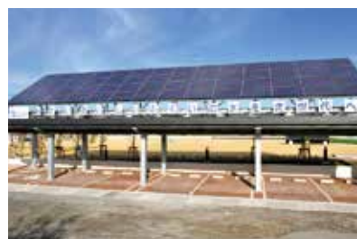
太陽光発電設備（森田浄水場）
