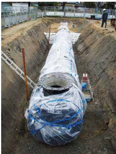
非常用貯水装置設置状況
