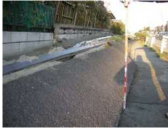
管路部の浮上
