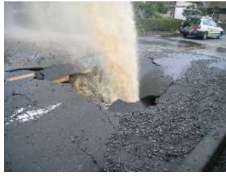
漏水による陥没
