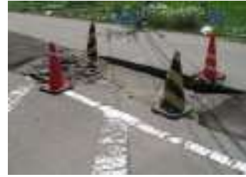
管路部の道路陥没
