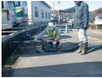
マンホールの浮上
