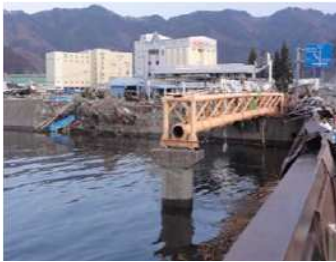
水管橋の被害
