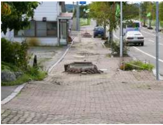
マンホールの浮上
