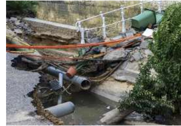
落橋による管路の破断
