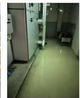
⑤地下機械室
