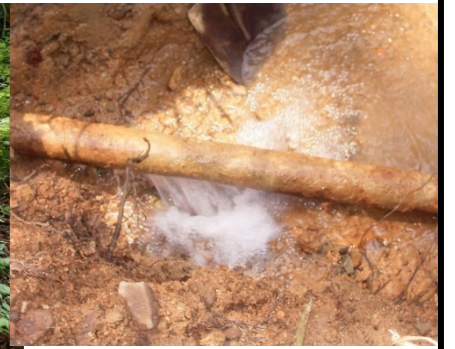
管の老朽化による漏水
