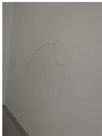
<階段壁の壁面剥離>
