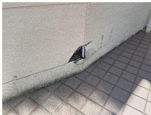
<内部が剥き出しになっている>
