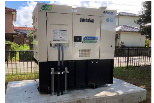
<空調設備(発電機)>
