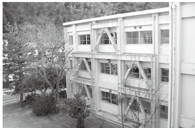
▲小中学校校舎に耐震補強工事を行い、安全な環境づくりに努めています。
