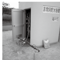
非常用貯水装置
