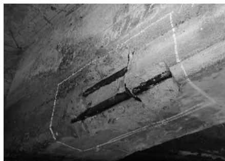
コンクリートが剥がれ落ち、中の鉄筋があらわになった部分（大森橋）
